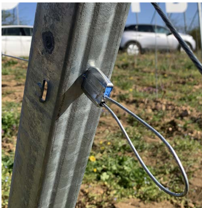
GP č.1 nainstalovaná na ocelovém sloupku.
